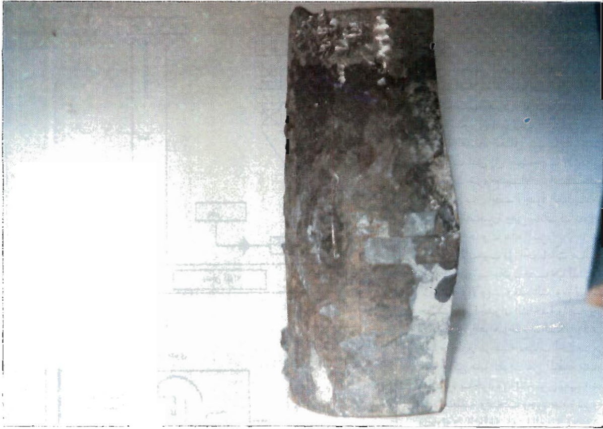
شكل (2) : - مظهر عام للأنابيب المنهارة .
