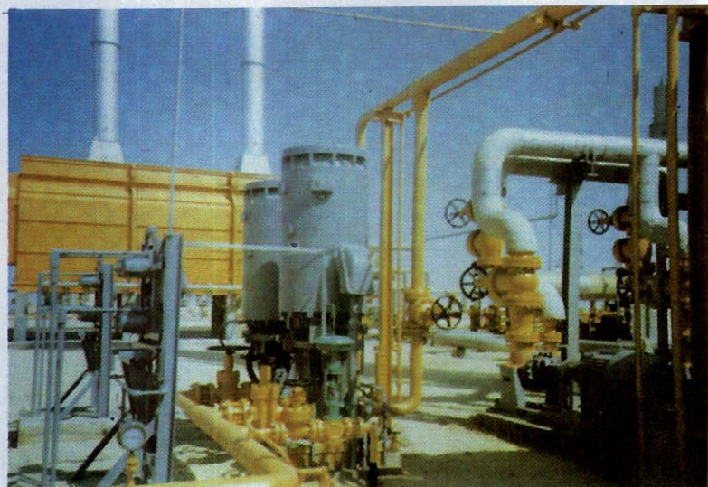
وحدة حقن المياه بحقل الجبل
